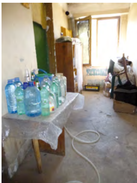
Centre collectif de Tskhaltsitela - Couloir, la vieille batterie, les réserves d'eau, peinture écaillée et calfeutrage artisanal des fenêtres
