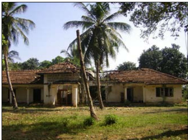
Vestiges d'un bâtiment de l'Agrarian Service Center , administration publique, dans la zone de Puthukkudiyiruppu
