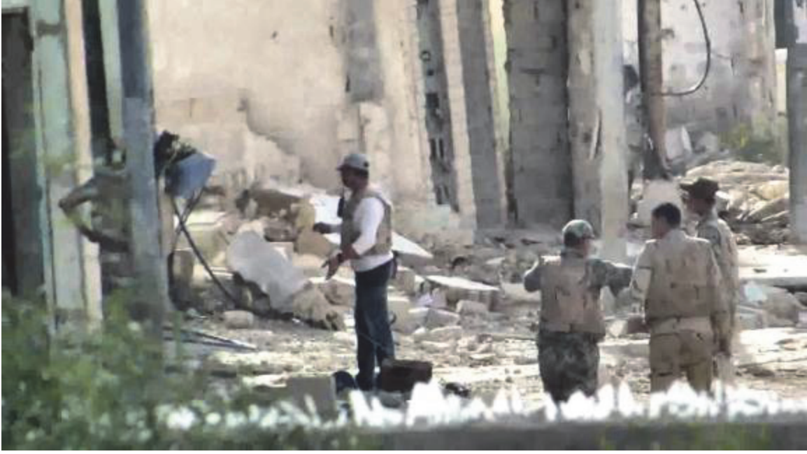
مقطع فيديو يظهر جنوداً يضعون شحنات التفجير ويوصلون أسلاكها في مبنى يتم هدمه فيما بعد.
