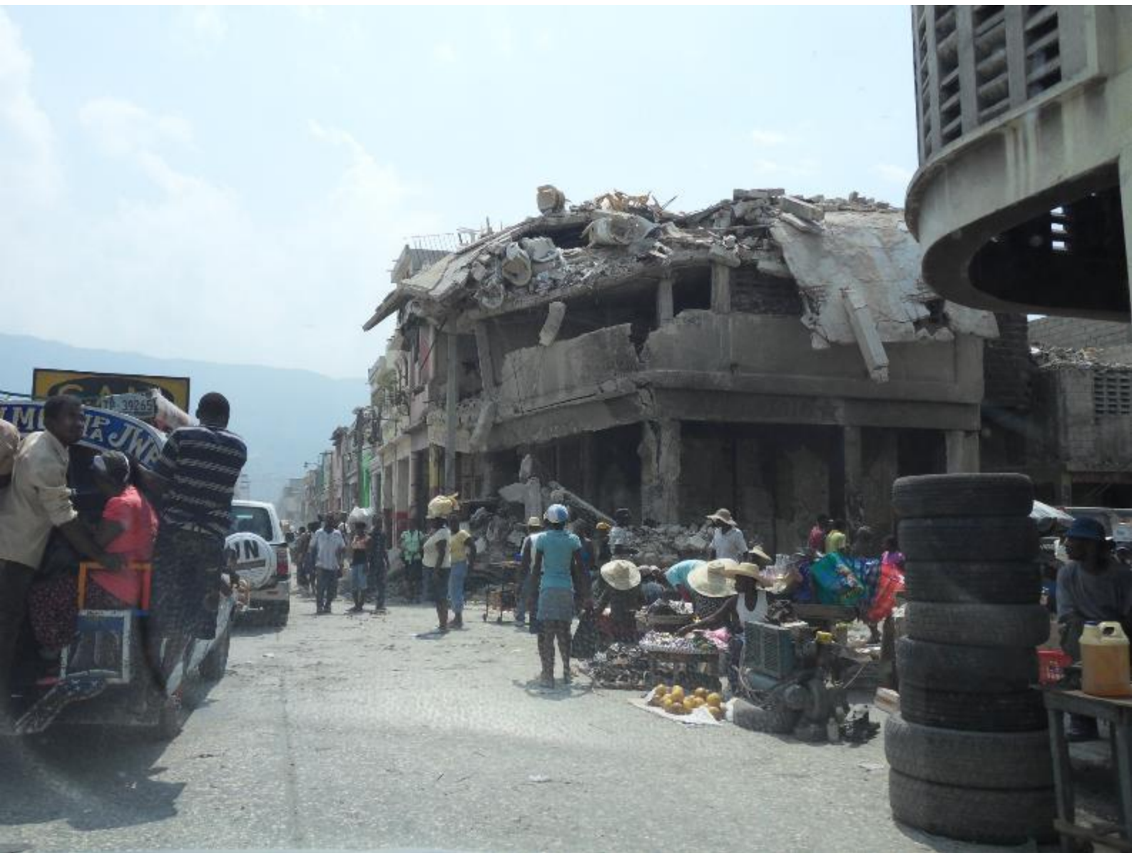
Ci-dessus : Rues du centre ville de Port-au-Prince témoignant de l'ampleur des destructions, mars 2010.
