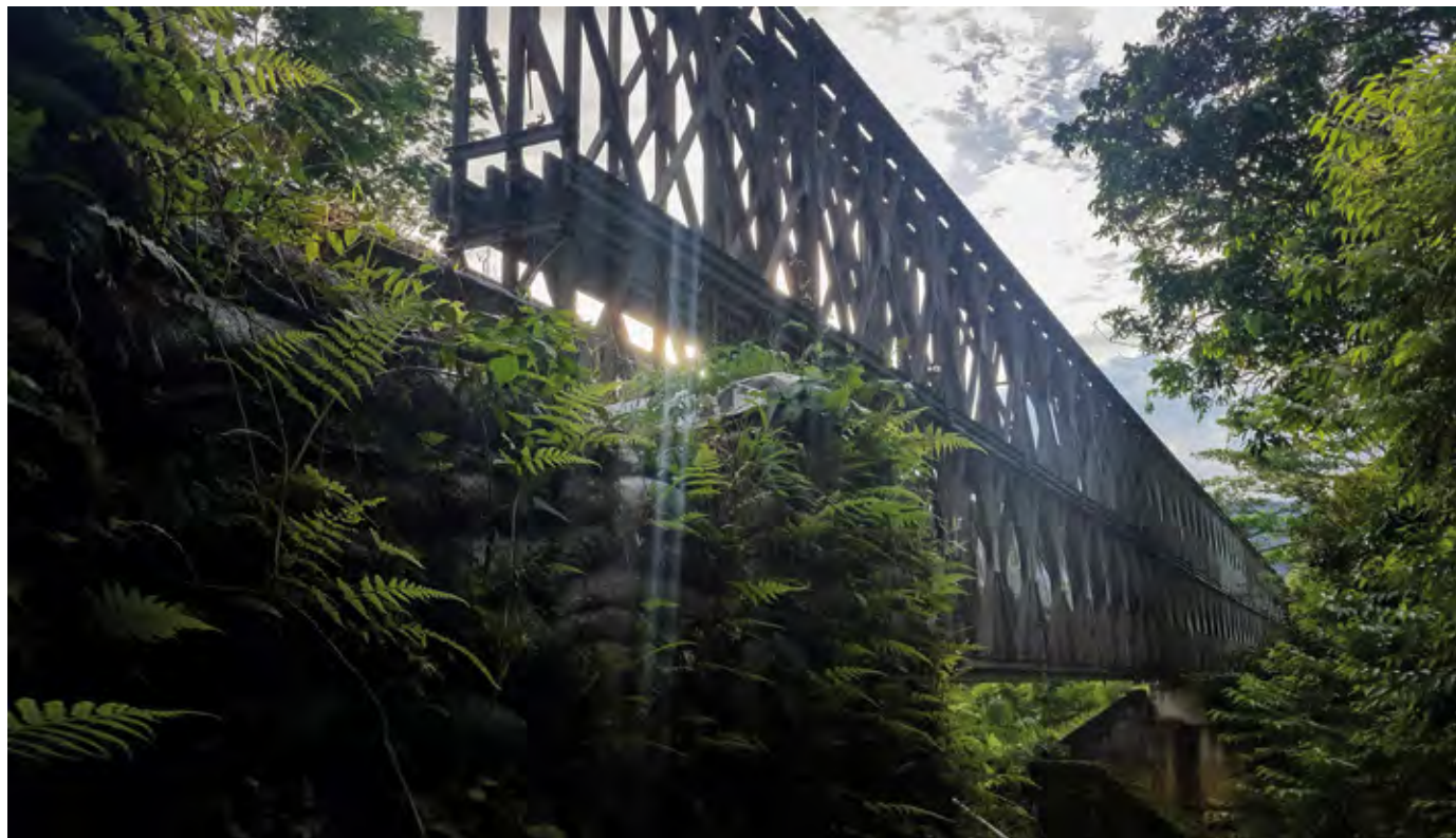
Trinchera en el puente del río Guayas, Puerto Rico (Caquetá), 2017. Fotografía: Javier Díaz Melo para el CNMH.
