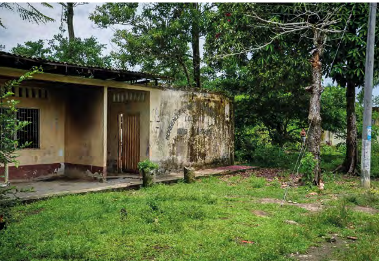
Ruinas del colegio Gerardo Valencia Cano. Puerto Torres, Belén de los Andaquíes (Caquetá), 2014. Fotografía: César Romero Aroca para el CNMH.
