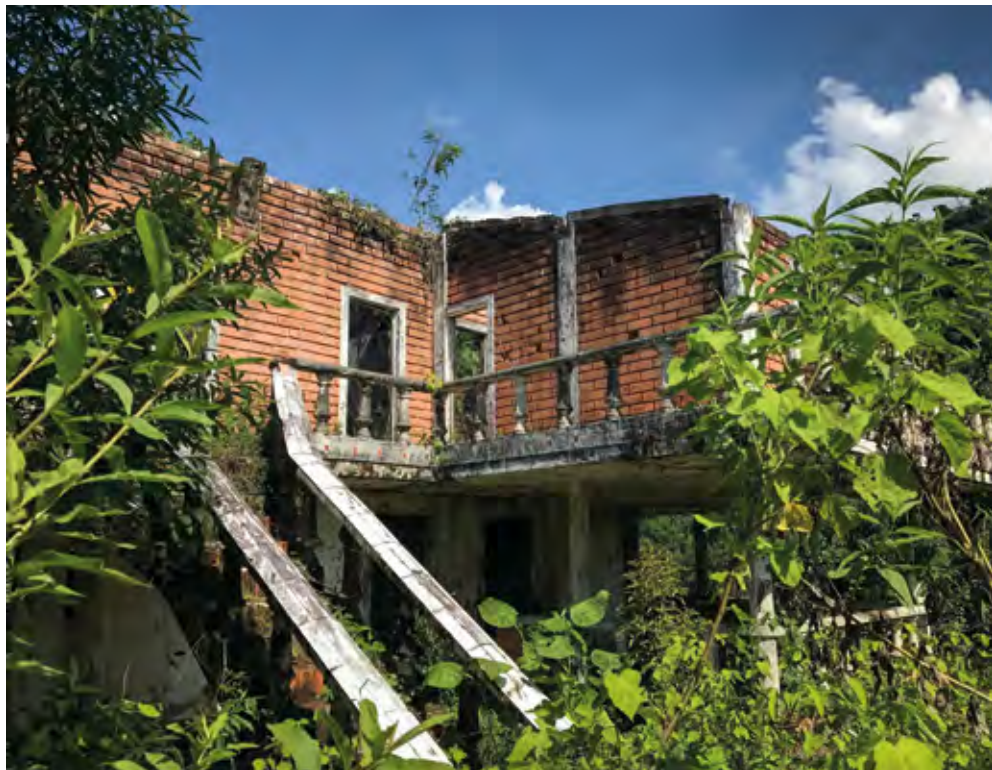
Casa en ruinas. Puente Linda, municipio de Nariño (Antioquia), 2017. Fotografía: Javier Díaz Melo para el CNMH.
