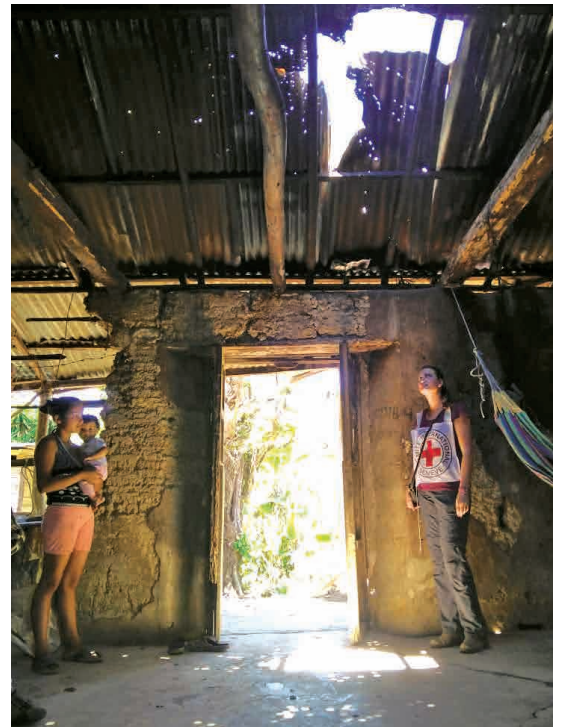
Así quedó el techo de la vivienda de esta familia luego de un enfrentamiento armado en la región del Catatumbo.
