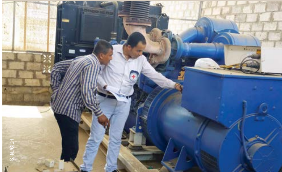
Un ingeniero del CICR comprueba el motor de un generador eléctrico en el hospital de Al-Thawra, en la gobernación de Hodeida. Mayo de 2016.
