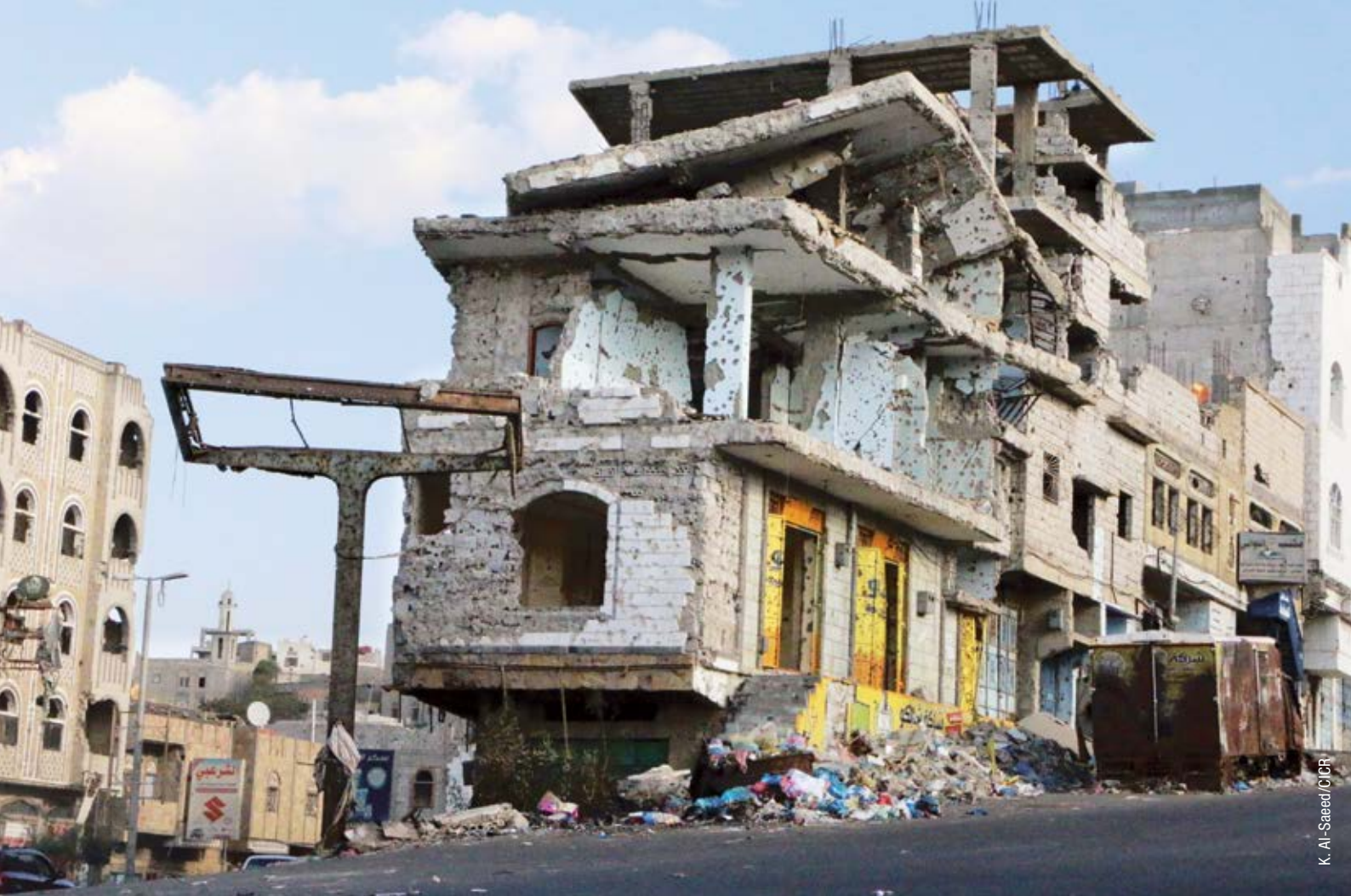
Un edificio civil parcialmente destruido, en la ciudad de Taiz, arrasada por la guerra. Diciembre de 2016.
