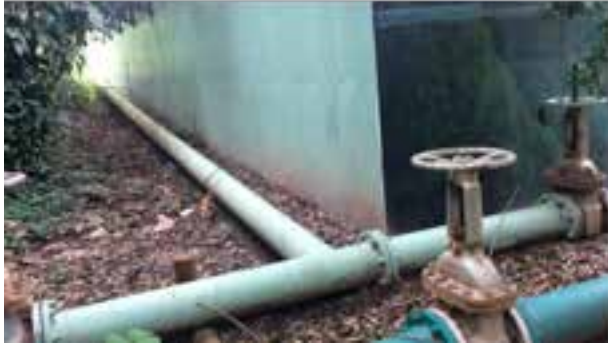
Punto de vertimiento N. 1: Se aprecia una línea paralela al tanque con válvula independiente que permite el paso de aguas sin necesidad de pasar por el separador de aceite (28.20.15). © FOTO/ SOLENERGY (2015).
