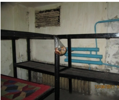
Отопление в камере.
