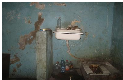
Напольный унитаз в камере (палате) приёмника-распределителя ГУВД г. Бишкек
