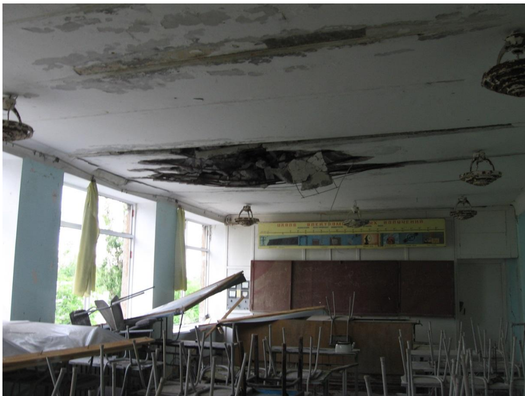
Ужгород. В здание школы № 42 в период боев за город в январе-феврале 2015 г. было шесть артиллерийских попаданий. Здание пока не восстановлено.
