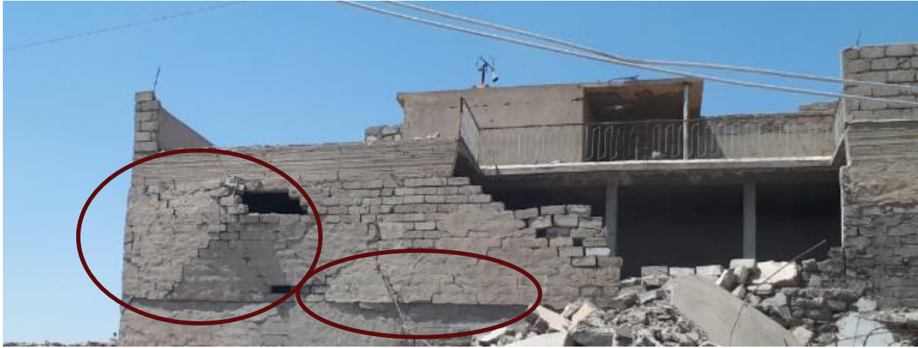
Leaning walls and cracks الجدران المائلة والشقوق
