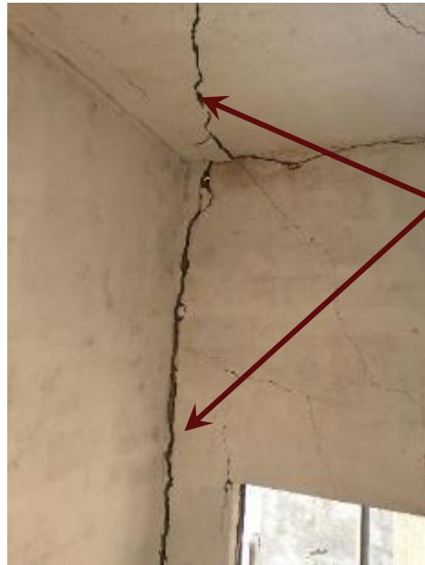
Structural cracks in walls and slab الشقوق الهيكلية في الجدران والسقف
