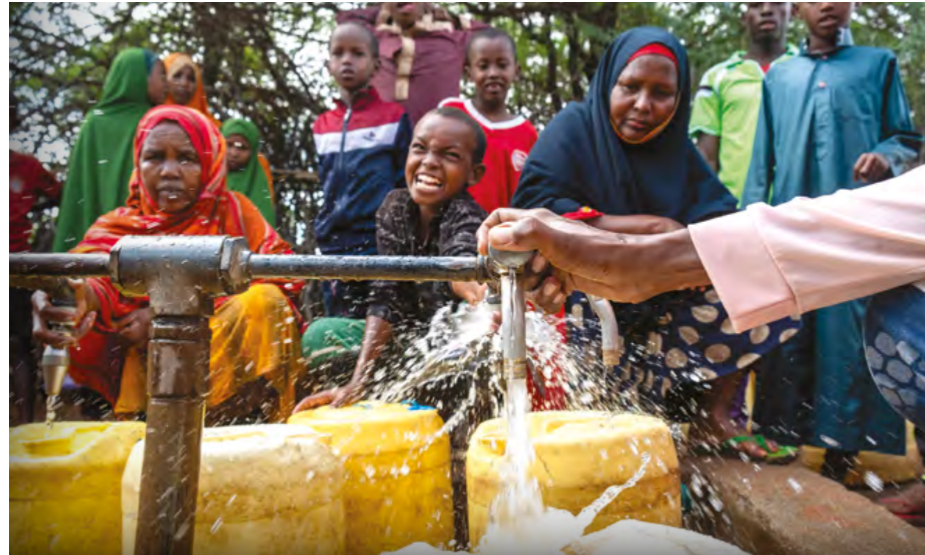
Des réfugiés somaliens collectent de l'eau à un point d'eau dans le camp d'Hagadera, à Dadaab, au Kenya. Le HCR fournit de l'eau à plus de 200 000 réfugiés dans ce camp et 19 de ces forages fonctionnent grâce à un système hybride solaire photovoltaïque-diesel.
