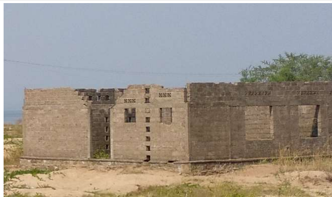
Logement en béton armé et remplissage blocs de sable-ciment en cours de construction à Kalemie, Tanganyika
