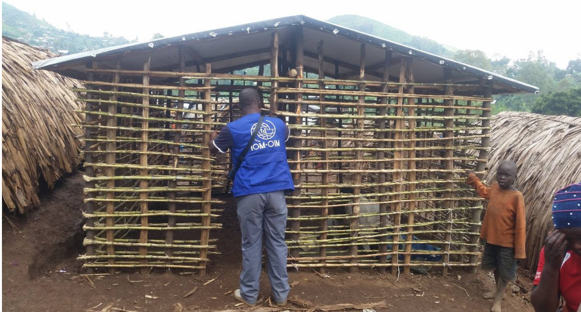
Abri en construction par OIM au site de Kabizo, Nord-Kivu, ©IOM/Delphin SH., 2019
