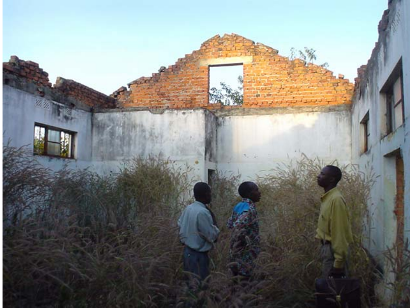
Un des pavillons en ruine de la prison de Buluwo (Katanga)
