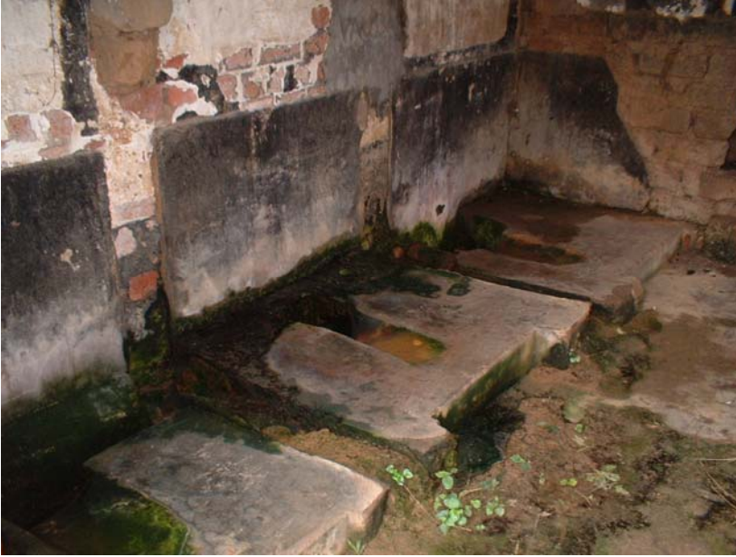
Les installations sanitaires de la prison de Bandundu
