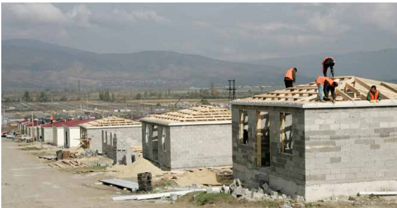
Muncitorii georgieni construiesc case pentru refugiați în satul Țerovani, la 30 km distanță de Tbilisi, la 20 octombrie 2008 - Autor: AFP PHOTO / VANO SHLAMOV
