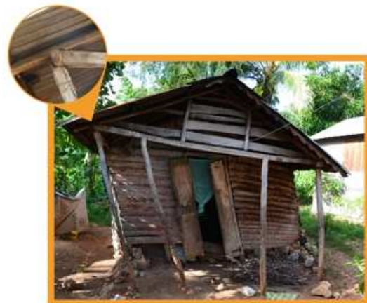
Maison en structure bois ayant subi le séisme de 2010 (Jacmel). La structure s'est déformée, mais ne s'est pas rompue
