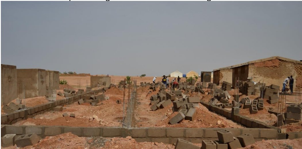
Les nouvelles salles en construction (centre) et les anciennes en détérioration (à droite) au camp d'Iridimi. Photo HCR/I. Diane
