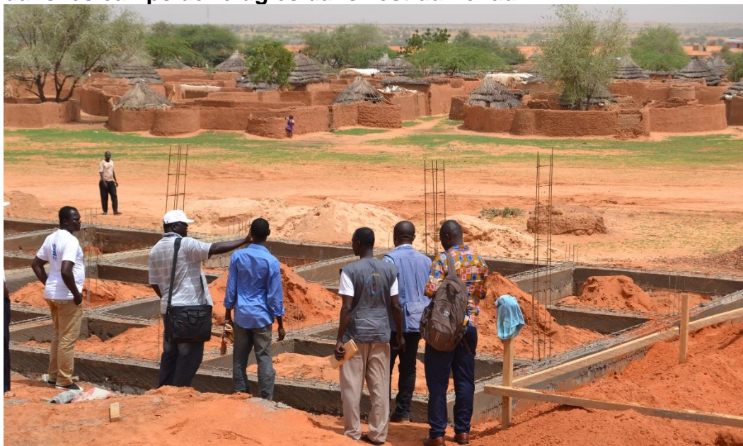
La mission se rend compte du progrès des travaux sur le chantier d'une école secondaire dans le camp de Touloum. Photo HCR/I. Diane
